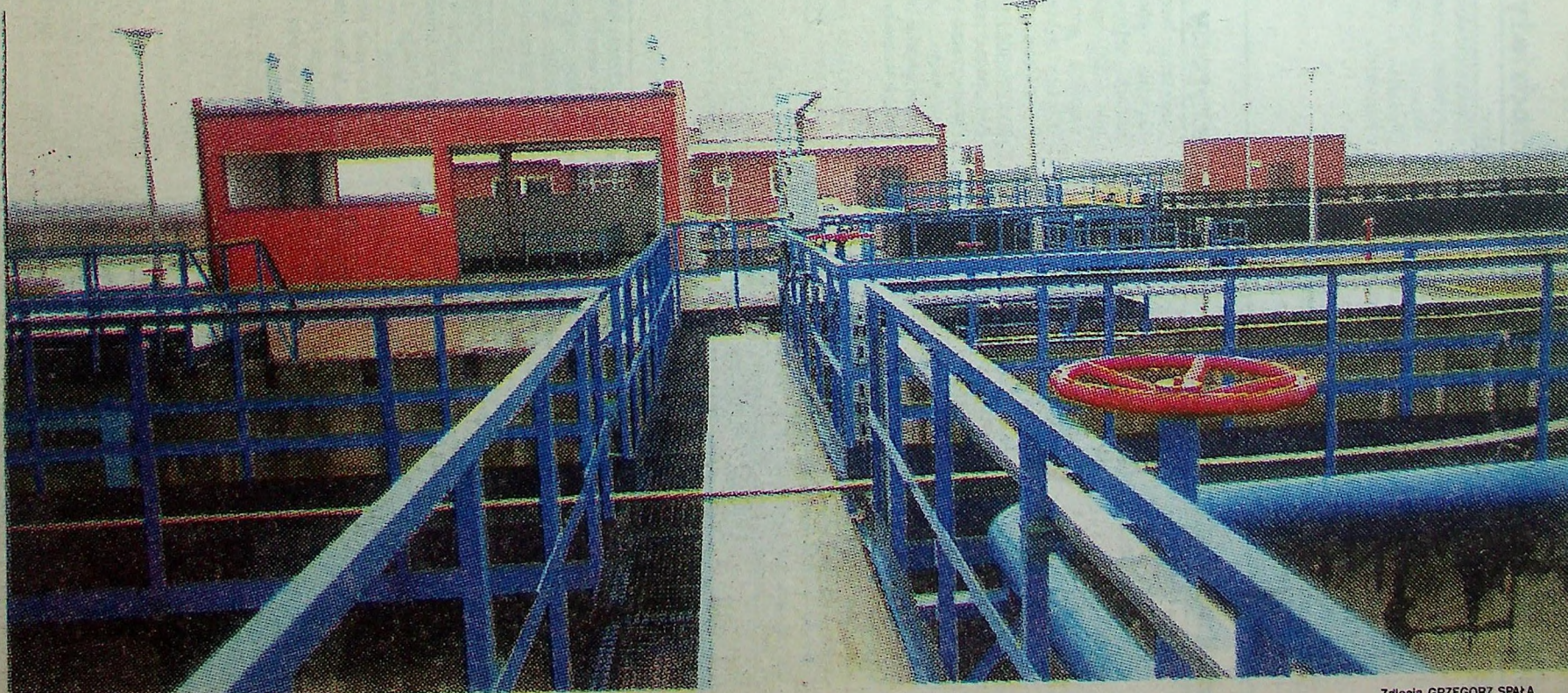
Oczyszczalnia ścieków w Ścinawie
