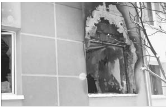
Pożar zaczął się prawdopodobnie w jednym z pokoi, spłonął on bowiem całkowicie wraz z wyposażeniem. Drugi pokój jest w nieco lepszym stanie. Zniszczona została też część elewacji budynku
