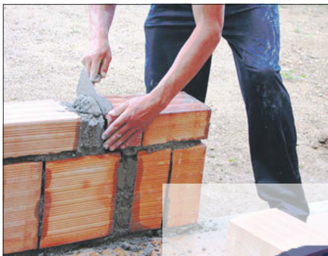
36-letni mieszkaniec powiatu legnickiego trafił do szpitala. Spadł z dachu, a potem zawaliła się na niego ściana
