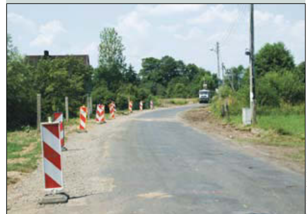
Modernizacja ma polegać na tzw. naprawach częściowych, czyli łataniu dziur w drogach, a zwłaszcza tych, które zagrażają bezpieczeństwu ruchu drogowego
