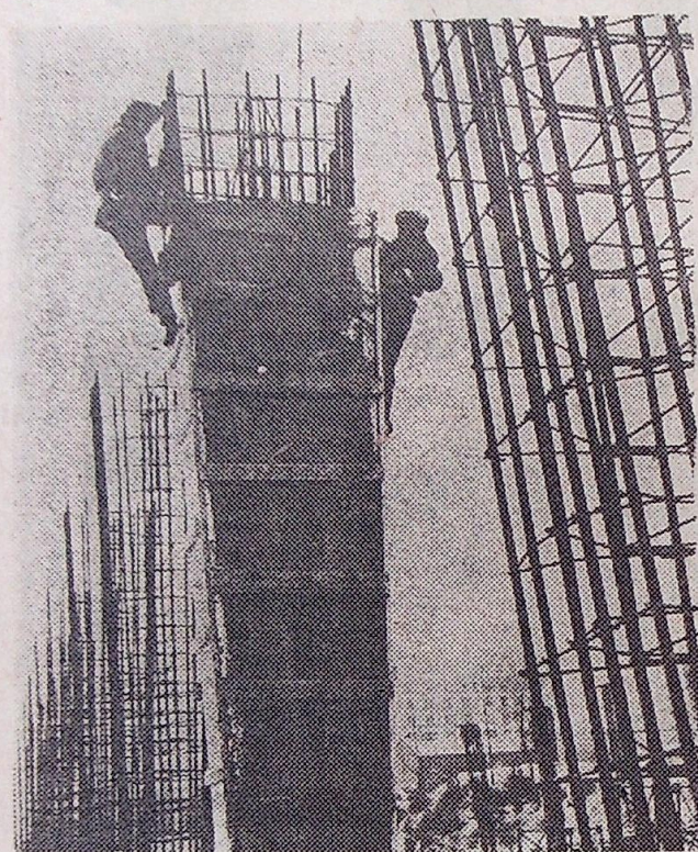
W betonowych słupach podtrzymujących betonowe nie zapomniano uszczelnić miejsce kotwienia... CAF — Dąbrowiecki
