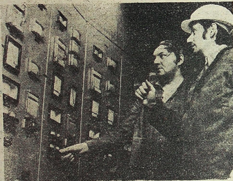
Sterownia. Edward Drupkowski i Henryk Ciak kontrolują pracę urządzeń oczyszczających.
