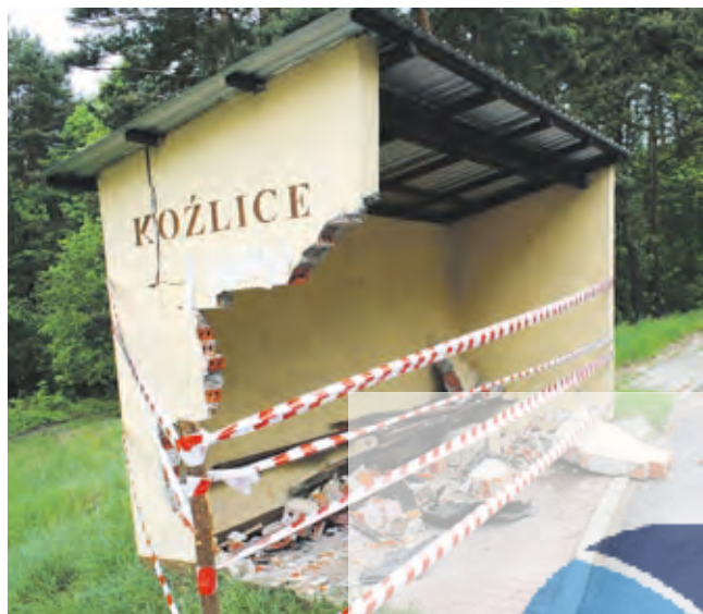
Kierowca uderzył w betonową ścianę przystanku
