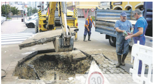
Woda wylała się na ulice. Ekipa techniczna, żeby usunąć awarię musiała rozkopać drogę
