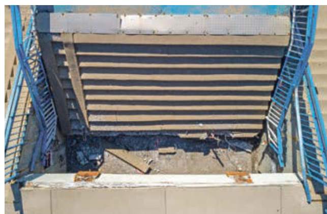
W poniedziałek 15 kwietnia zawaliły się schody od strony centrum miasta
