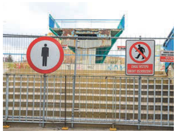
Kładka zawaliła się w kwietniu ubiegłego roku
