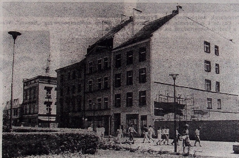
W remontowanym przy ul. Rosenbergów w Legnicy budynku wmurowano znacznie więcej stali niż to było potrzebne.
