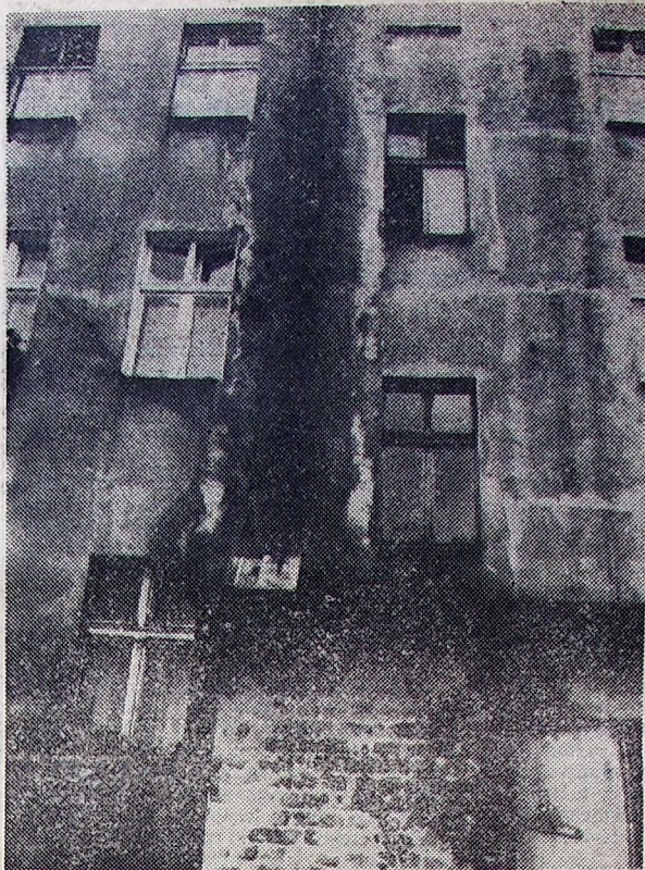
Brak kawałka rynny sprawił, że woda leje się po ścianie. Na razie powstał zaciek, już niedługo posypie się tynk. Budynek cały zawilgocony.
