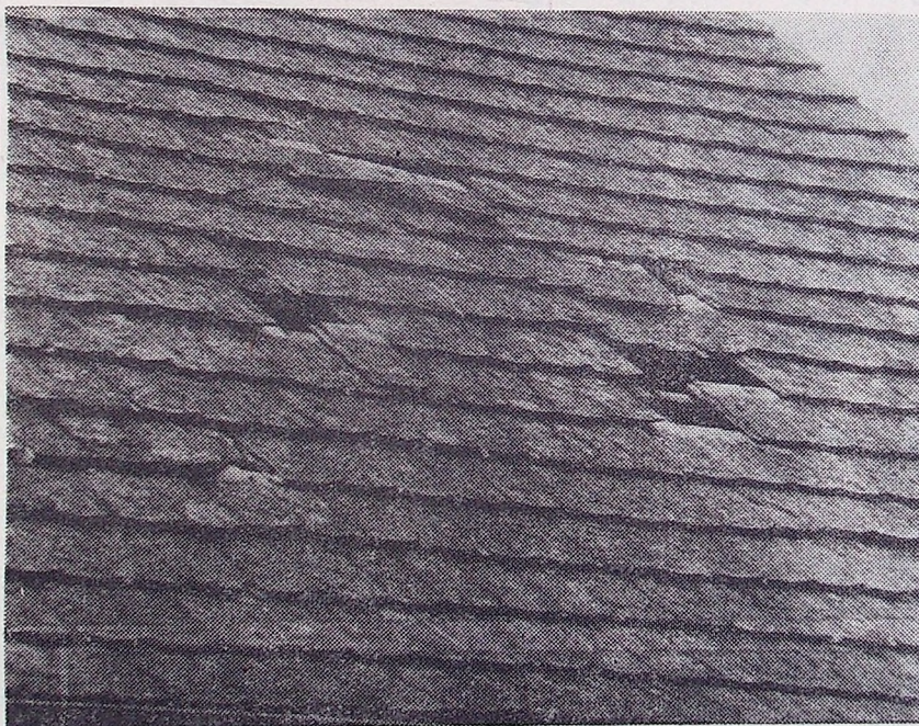
Kilka dachów zostało uszkodzonych.
