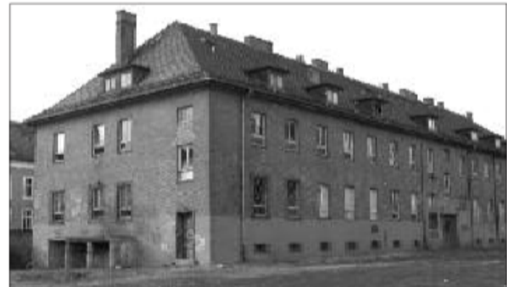
Powybijane szyby, zniszczone drzwi, a na ścianach wielkie graffiti – budynek przy ulicy Kościuszki wywołuje oburzenie mieszkańców
