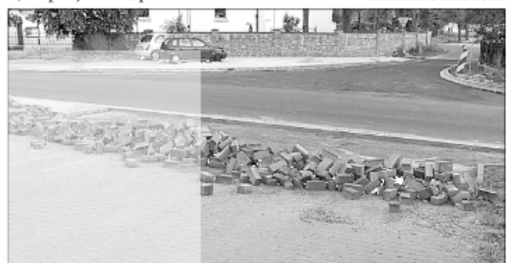
Robotnicy pozostawili teren niezabezpieczony i nieoświetlony, tym samym powodując zagrożenie dla przechodniów
