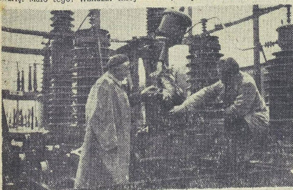
Podczas ostatniej burzy „wysiadł” izolator. Na zdjęciu: dyżurny rozdzielni, p. Józef Gawiński oraz kierownik sekcji eksploatacji p. Marian Fudali. Fot. R. Nader
