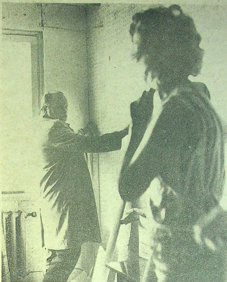
W mieszkaniach budynku 203 w Lubinie (osiedle „Przylesie”) trzeba z przemarzniętych ścian zrywać tapety i przyklejać płyty ocieplające.
