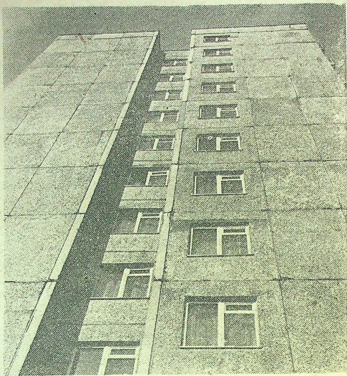
Budynek nr 2 na osiedlu „Porzdamka” z zewnątrz posiada niezłą elewację, wewnątrz — niechlujnie wykonaną klatkę schodową i sporo usterek mieszkaniowych.
