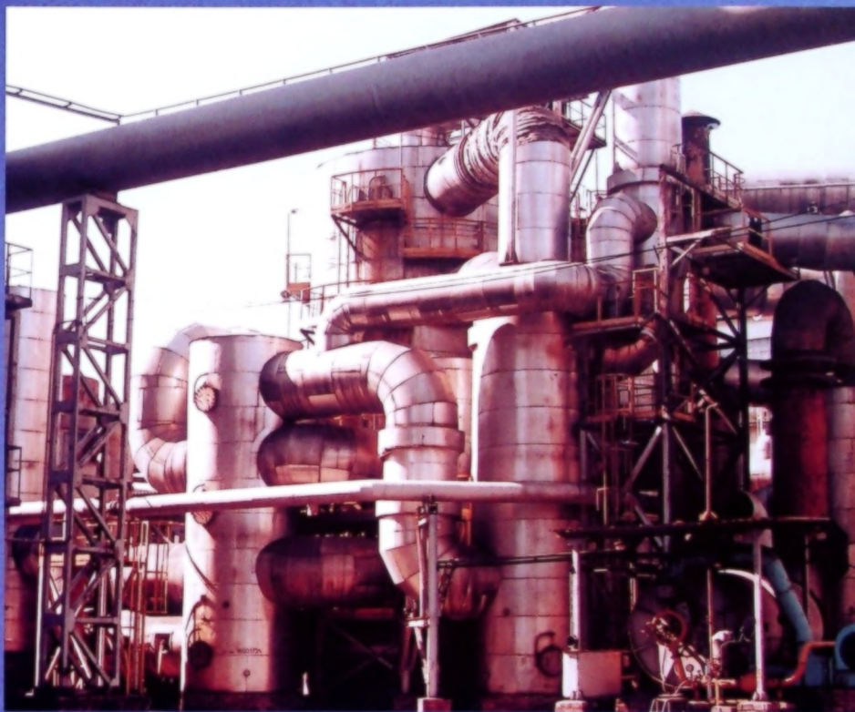
■ Fragment instalacji odsiarczania gazów technologicznych „Solinox”
