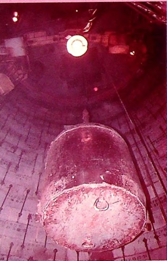
Obudowa panelowa w szybie L-VII
