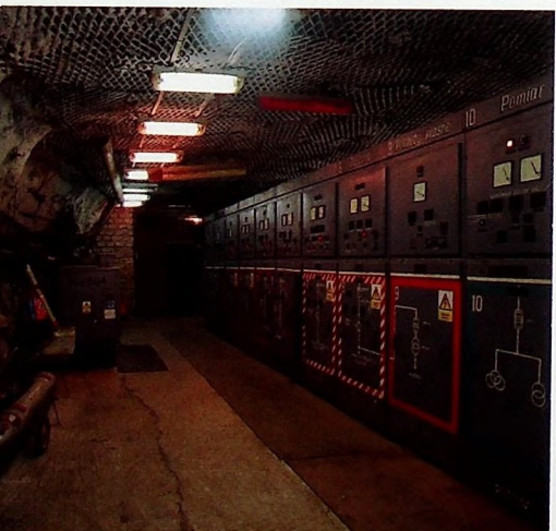
Rozdzielnia pompowni głównej
