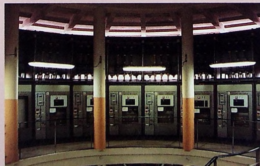
Rozdzielnia 6kV - KLG
