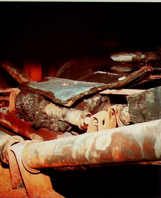
Taśmociąg po pożarze w chodniku retencyjnym
