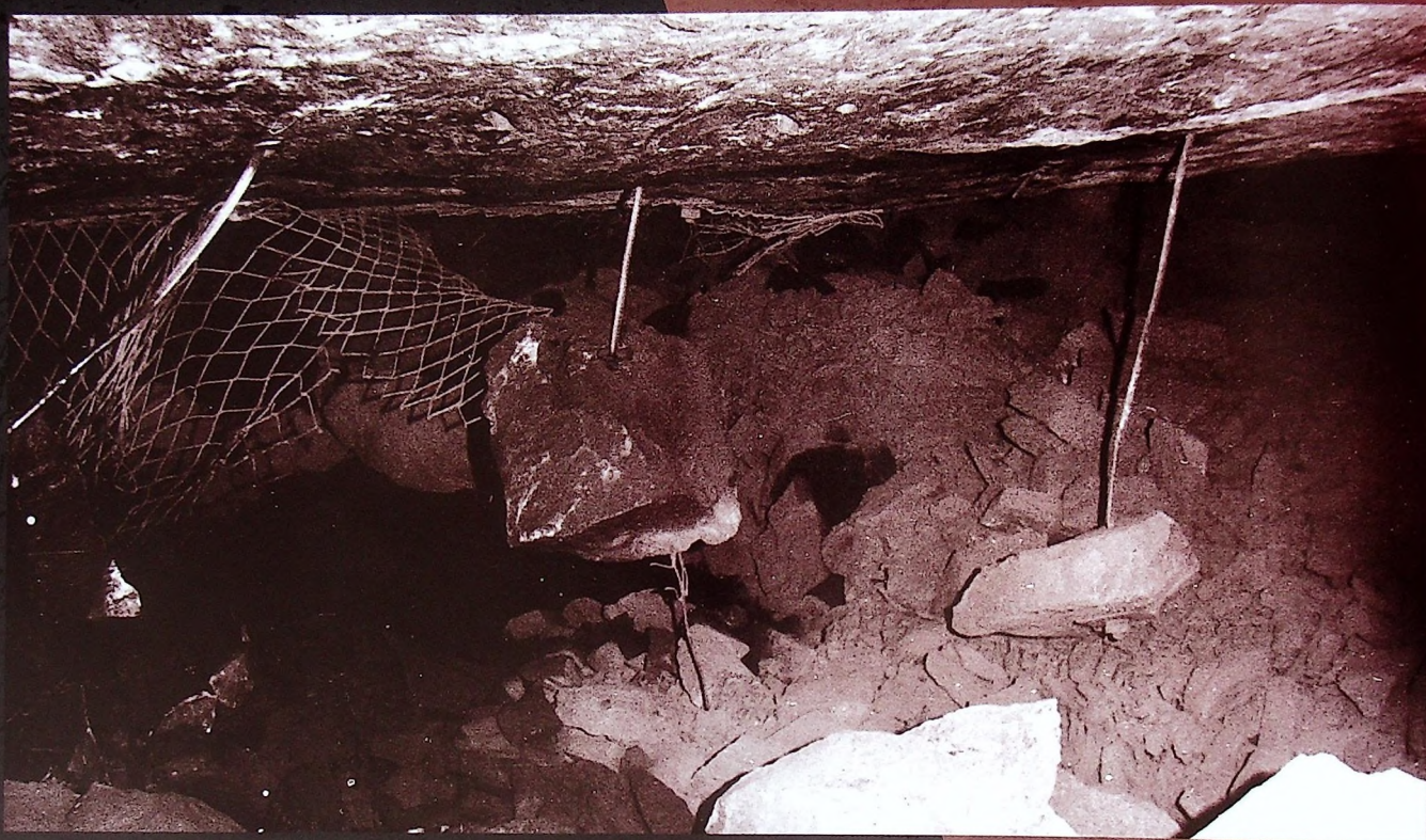
▲ Zawał skał stropowych w oddziale G-21
