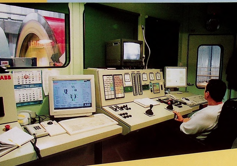
► Sterownia maszyny wyciągowej
