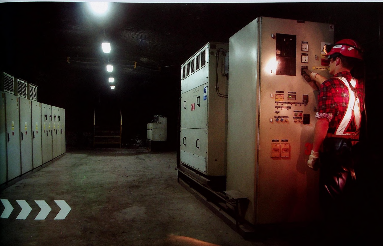
Dołowa rozdzielnia mocy w rejonie SW-I
