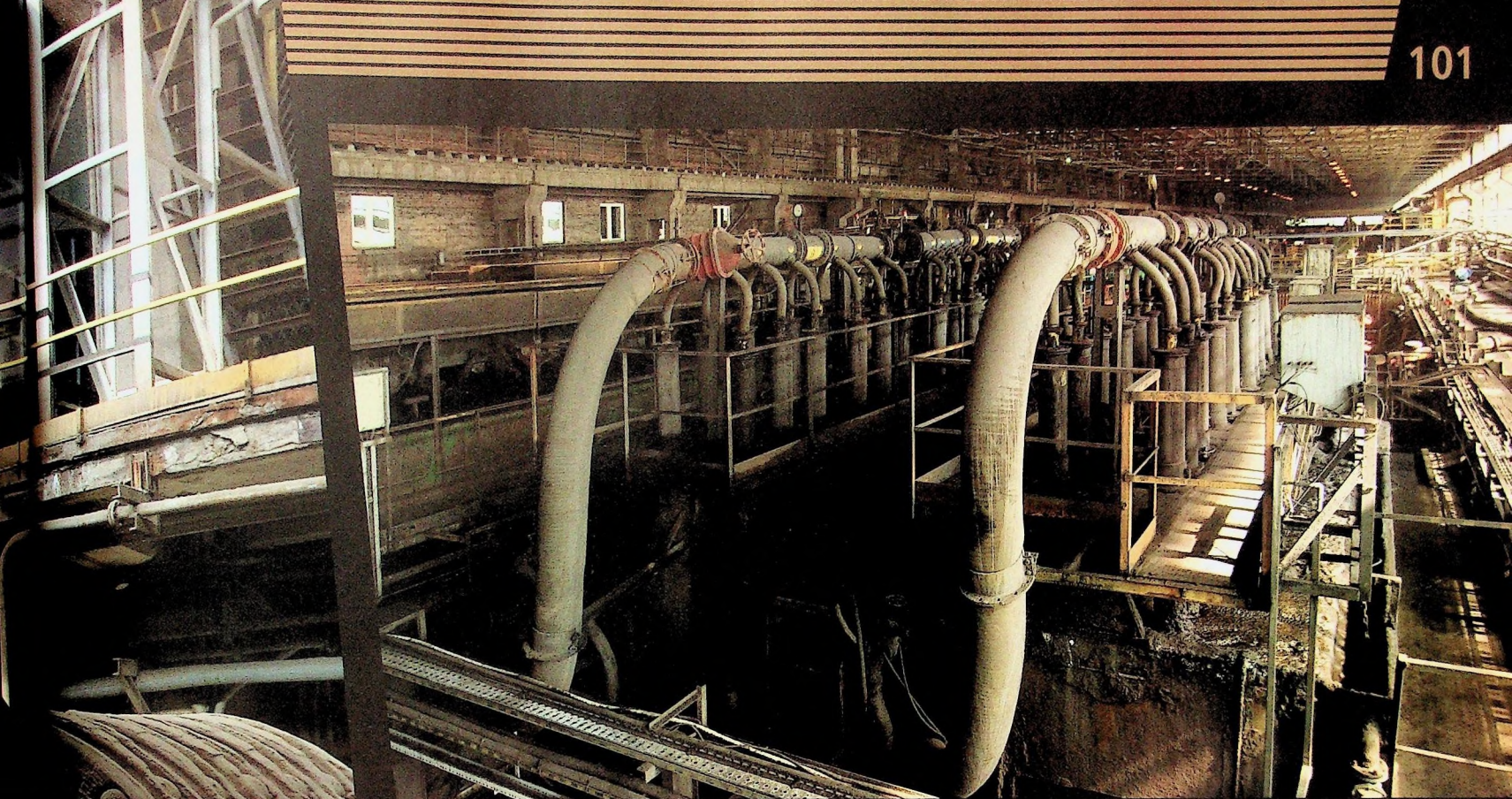
▲ Maszyny iniekcyjne - flotacja czyszcząca
