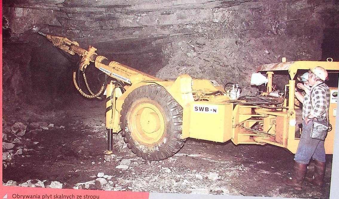
▲ Obrywania płyt skalnych ze stropu jest niezbędne dla zachowania bezpieczeństwa
