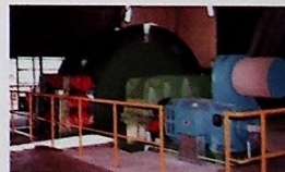
Maszyna wyciągowa po modernizacji.
