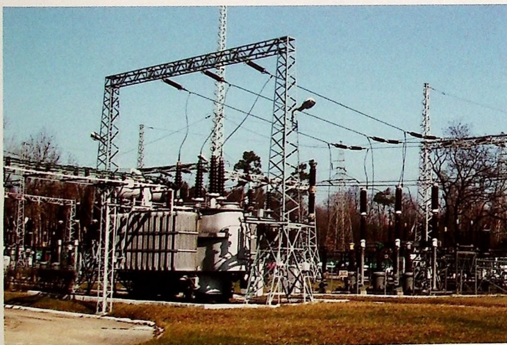
Stacja elektroenergetyczna KLG (GST-1) 110/6kV.
