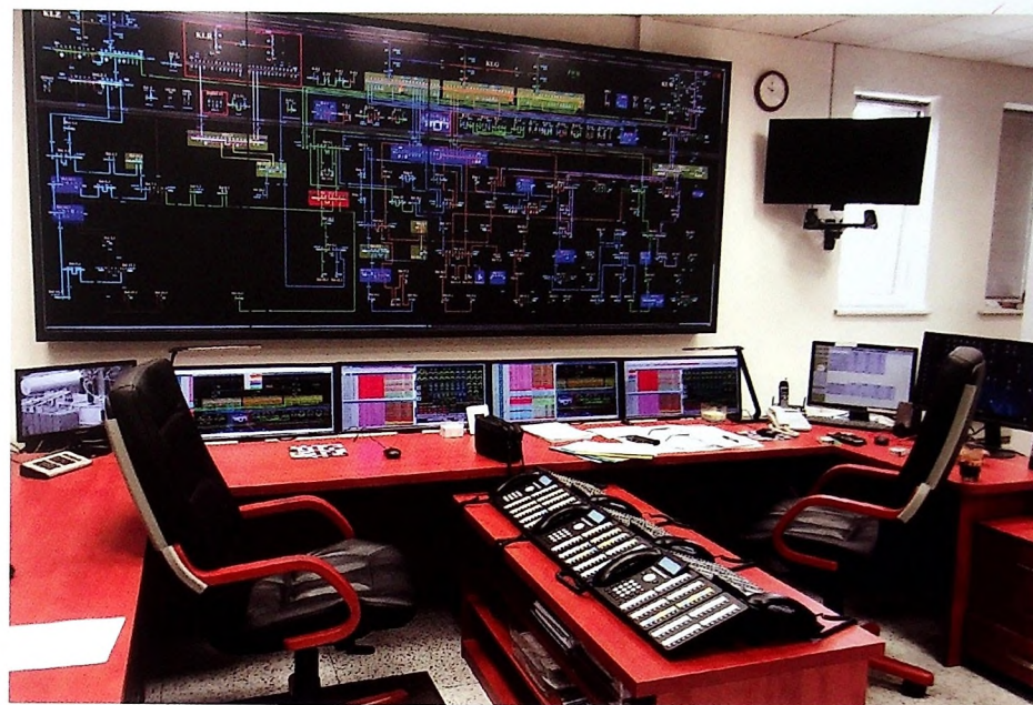
Dyspozytornia energetyczna z systemem sterowania i nadzoru SYNDIS.
