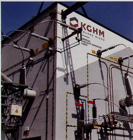
Przyłącza linii 110 kV stacji KLR.
