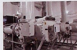
Rozdzielnia 110 kV GIS.
