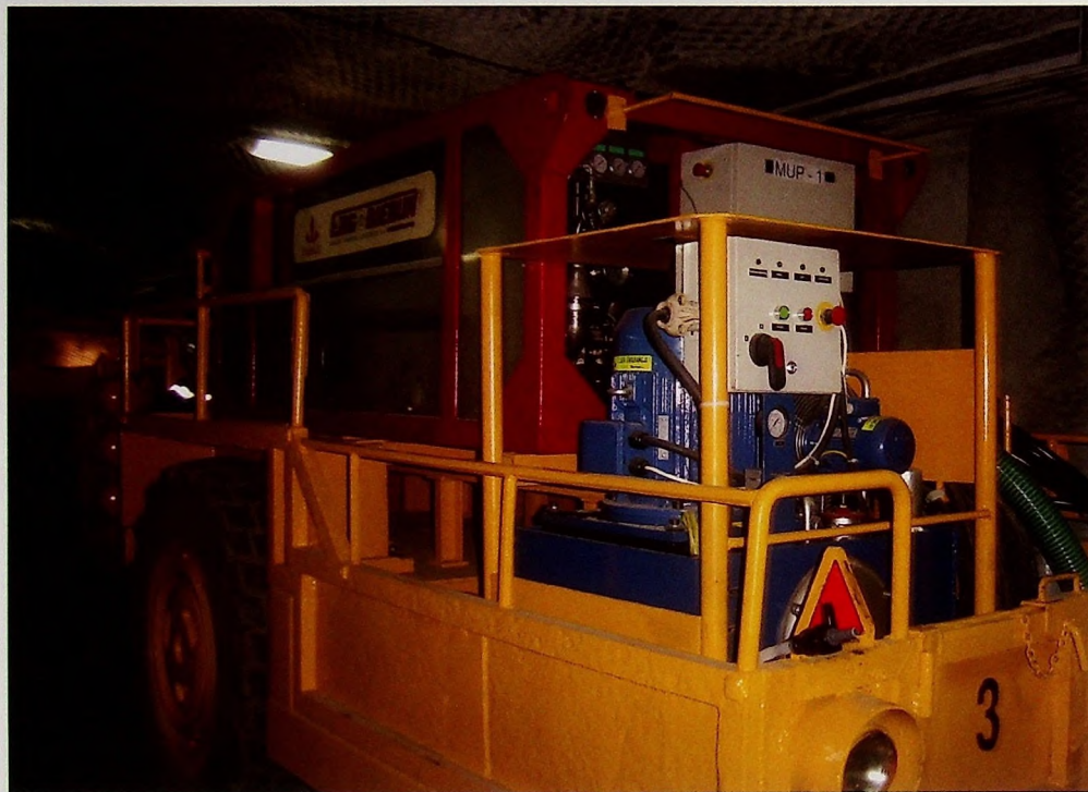
SWT z zainstalowanym MUP-1.
