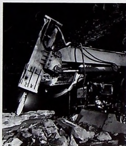
ROXON zamontowany na punkcie wysypowym w przecince nr P-8 przenośnika A-15.
