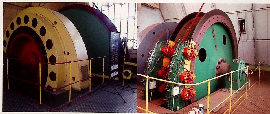
Maszyna wyciągowa L-I Zachodnia przed i po modernizacji (hamulec pneumatyczny bębnowy zastąpiony został hamulcem dwutarczowym hydraulicznym z siłownikami BSHG408).
