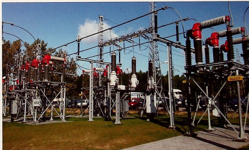
Stacja elektroenergetyczna KLG 110/6kV z nową rozdzielnią wykonaną w technologii Compass (wyłączniki próżniowe lub z gazem SF 6 i napędem elektrycznym).
