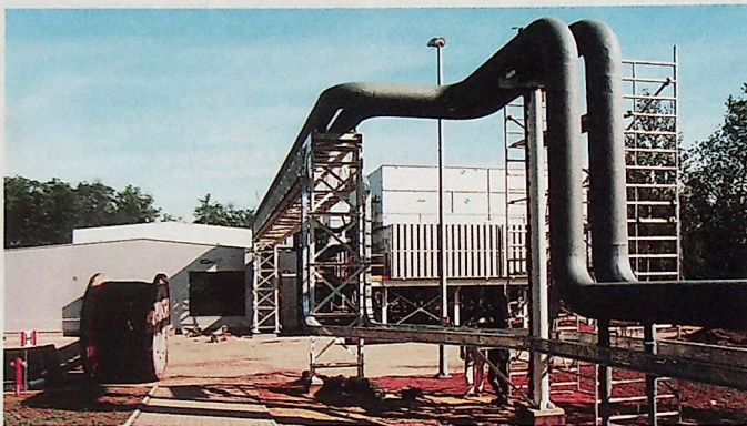
System klimatyzowania jest całkowicie nowatorskim rozwiązaniem w kopalniach miedzi
