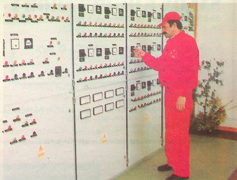
Nowoczesną oczyszczalnię ścieków w Prochowicach wybudowano przy finansowym wsparciu Wojewódzkiego Funduszu Ochrony Środowiska i Gospodarki Wodnej w Legnicy.
